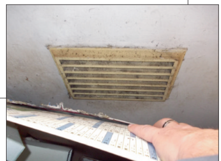
Amenée d'air basse existante
