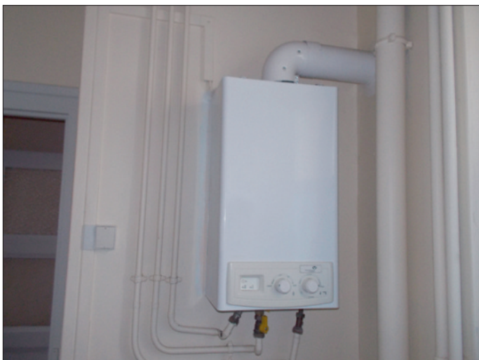
Chauffe bain à ventouse
